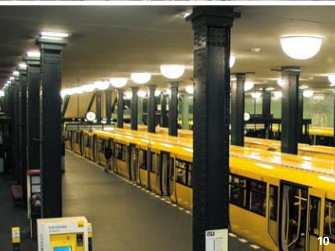
Die Ringform-Induktionslampe im Einsatz: Industriehalle (Bild 9), U-Bahn-Station Alexanderplatz (Bild 10) in Berlin, Hochregallager (Bild 11), Bibliothek (Bild 12), Kontrollstation (Bild 13) bei der Einfahrt auf ein Werksgelände, Ausstellungs- und Verkaufsraum (Bild 14).
